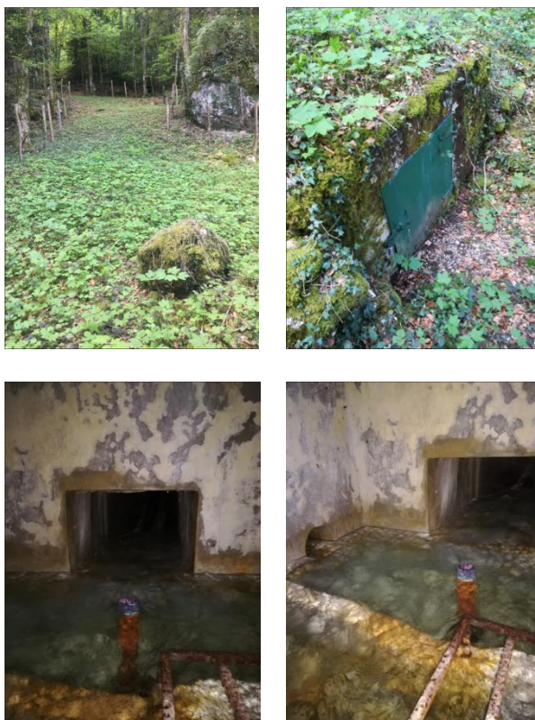
Figure 2 : Captage de Drevin – Photographies
