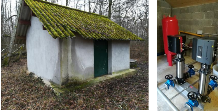
Figure 5 : Station de pompage au Lac – Photographies
